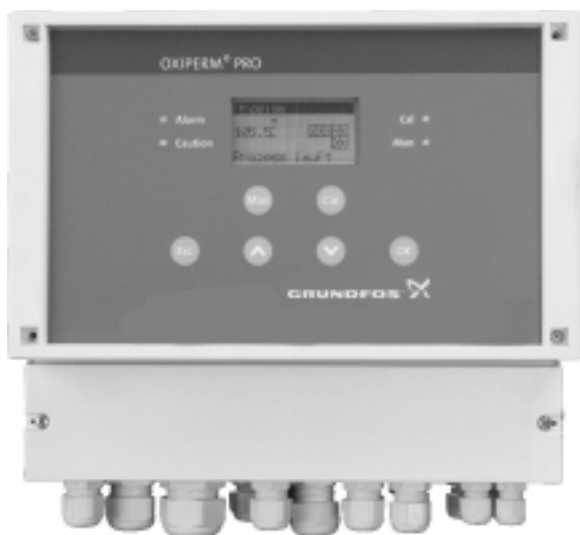
Рис. 26 Блок управления с кабельными муфтами
