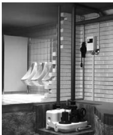
Рис. 103. Пример установки Multilift MDG в прямке в подвальном помещении здания
